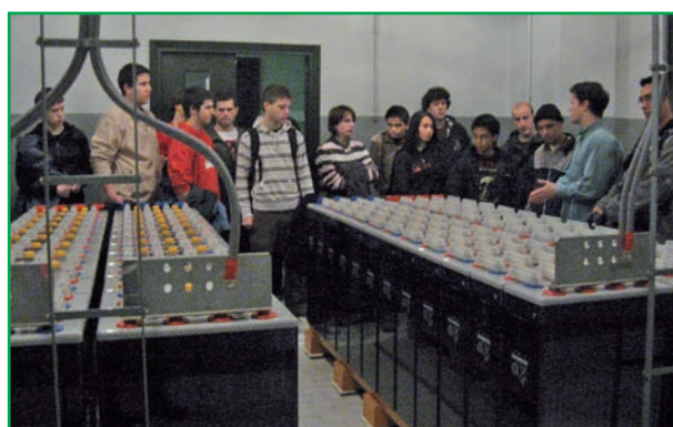
Recibiendo las explicaciones de un trabajador de la central telefónica de Larrañaga de Irún (en la foto la sala de baterías) en visita del grupo "Equipos Electrónicos de Consumo".
